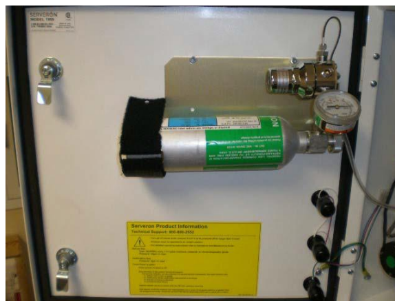
Figura 10: Botella de gas verificador instalada
