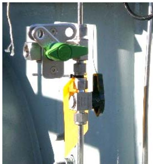
图 6 手工取油样口
